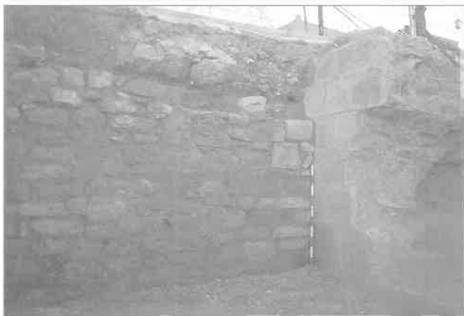
Lám. 6.- Prolongación de la Avda. Blas Infante. Refacción de la muralla junto a la Torre N° 4.
