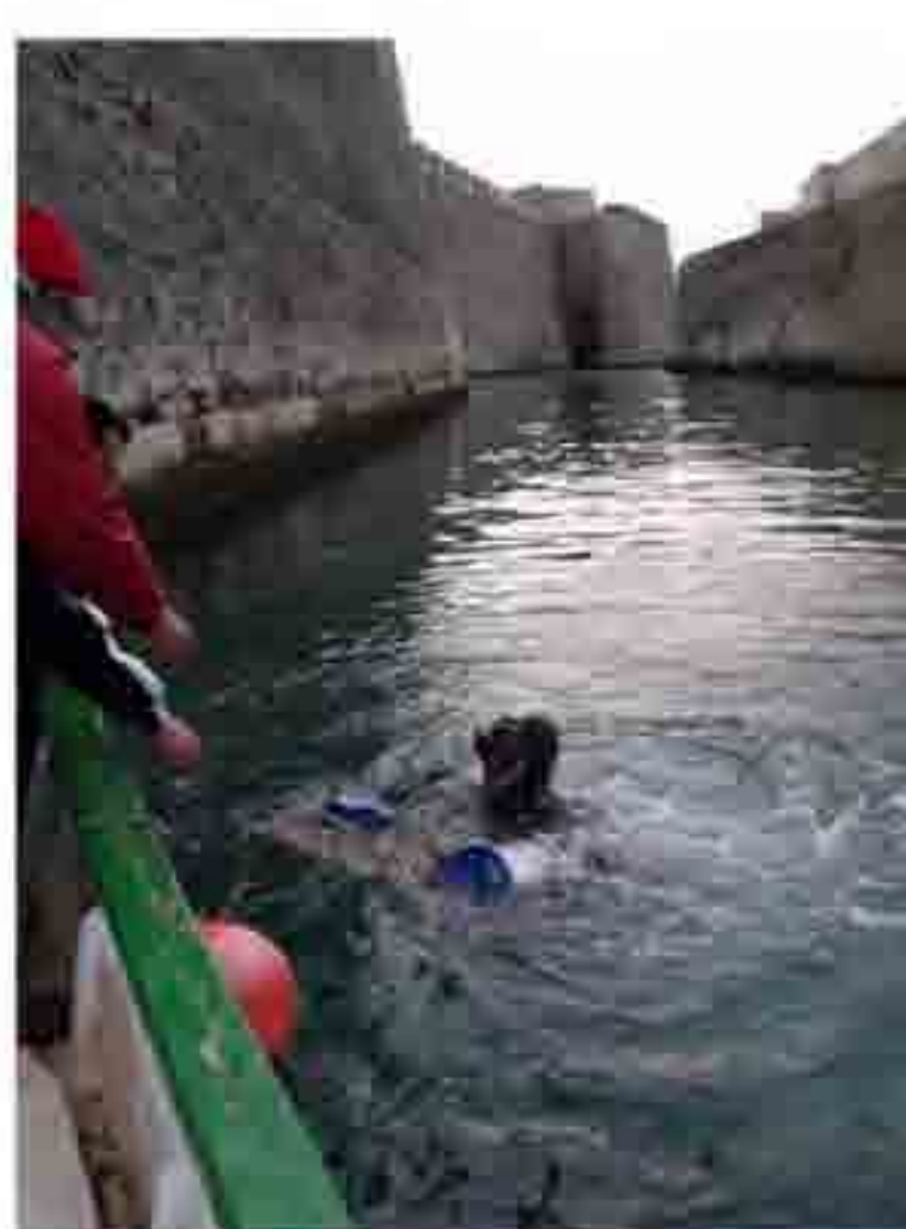
Campaña de campo de diciembre de 2013. Instalación de correntímetro de efecto Doppler (ADCP) y sensores para medida de corrientes, niveles y temperatura en el Foso de San Felipe.
